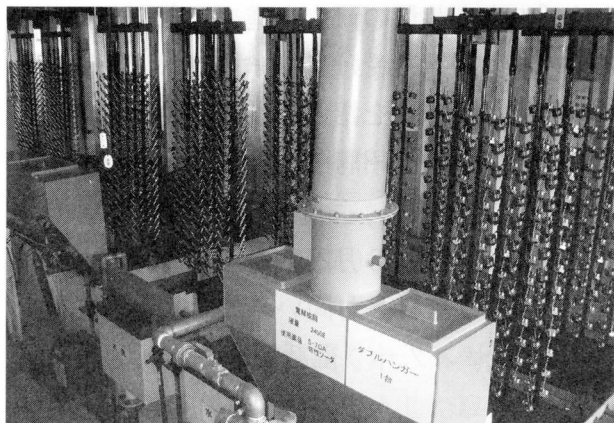
地下に埋設されためっきライン
